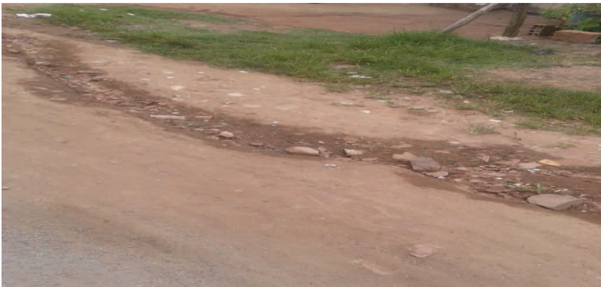
Imagem 3: Rua sem calçamento, com esgoto exposto.
