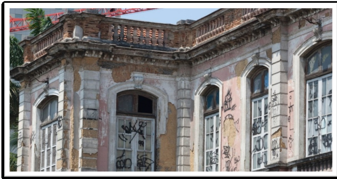
Figure 4 - Vista no detalhe do estágio de degradação do imóvel
