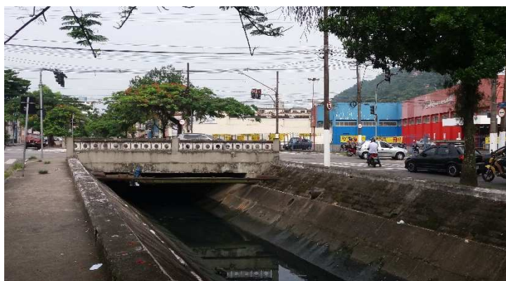
Figura 7. Vista atual da Ponte, já refeita e sobre viga de concreto comum.
