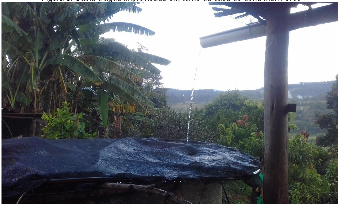
Figura 3: Caixa d'água improvisada em torno da casa de dona Mari Alves
