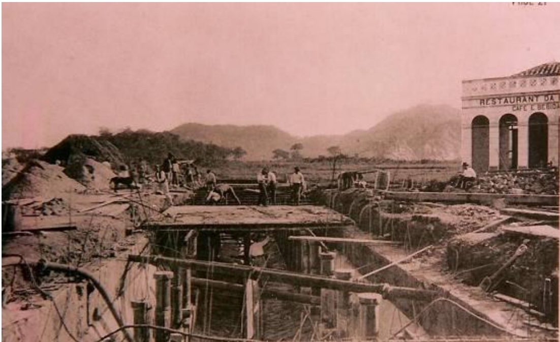
Figura 14-Início das obras do Canal 1, trecho da Vila Mathias. Fonte: Álbum Canais de Drenagem Superficial -1906-07
