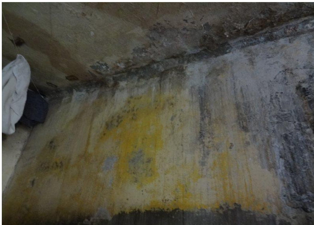
(infiltrações na parede, umidade escorrendo)
