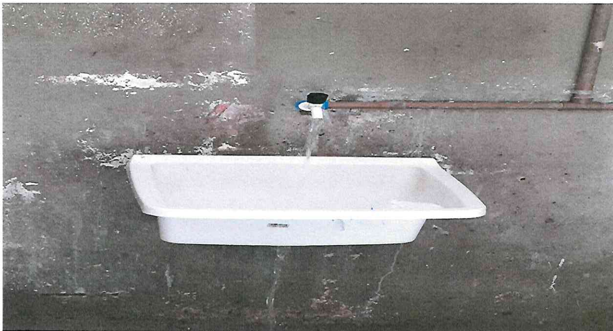
Torneira encontrada aberta jorrando água durante inspeção Coordenadoria de Unidades Prisionais da Região do Vale do Paraíba e Litoral
