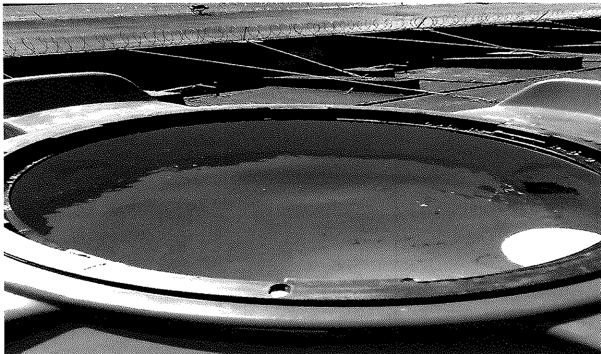
Reservatórios individuais das celas
