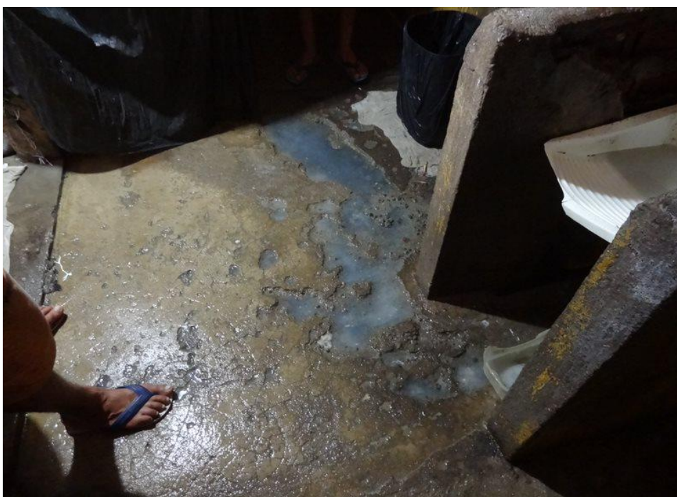
(água vazando, infiltrações, poças no chão)
