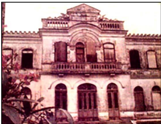
Figura 21 MPS em ruínas. Fonte: Instituto Elos
