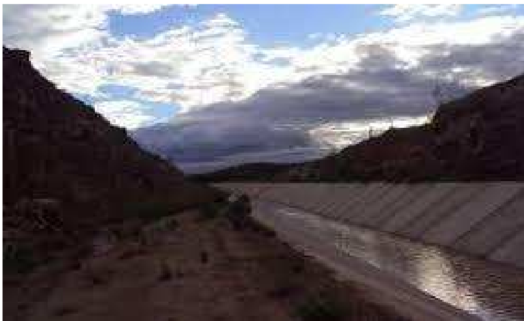
Figura 12 – Canal do Eixo Leste no município de Sertânia – PE.
