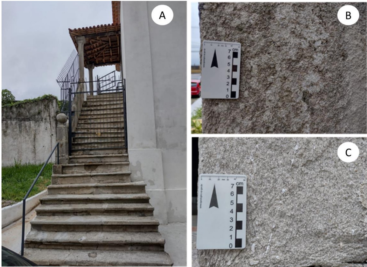
Figura 76 A, B e C – Litologia identificada na escadaria da Casa do Trem Bélico ou Trem Real.
