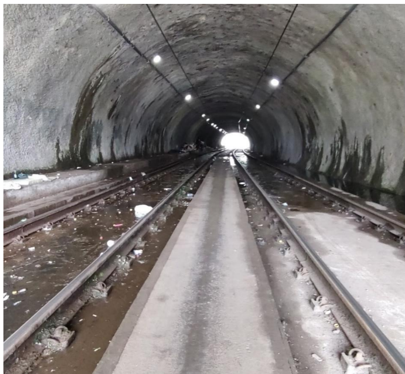
Imagem 1: Manchas na parede são infiltrações de água, usadas pelos adictos para beber
